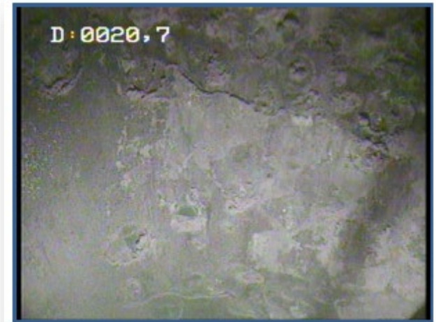
Dépôts recouvrant les parois des tubes
